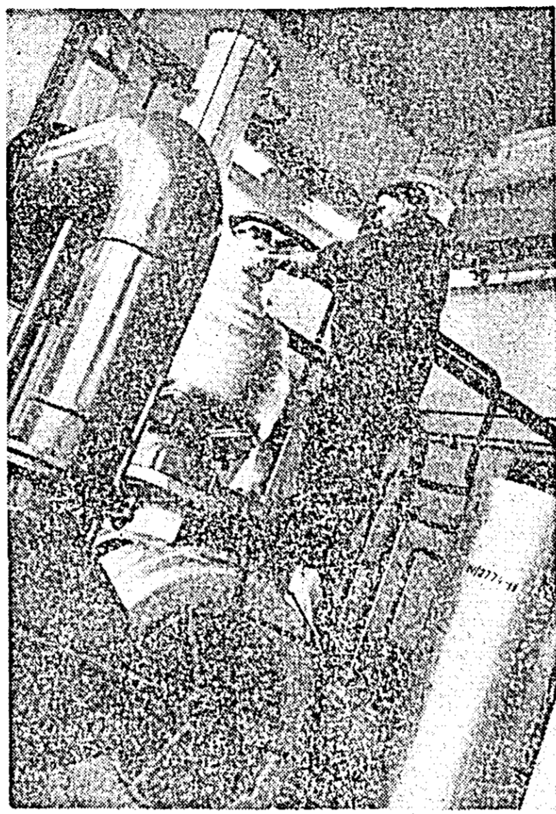
Aspect din secția oxigen a Uzinelor de vagoane. Maistrul Ioan Brix verifică buna funcționare a instalațiilor.
