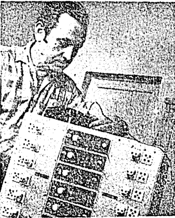
Atelierele CT 5 CFR Arad, Electronistul Ștefan Szegedy lucrînd la montarea panoului de cuplare pentru instalațiile de teleconferințe.
